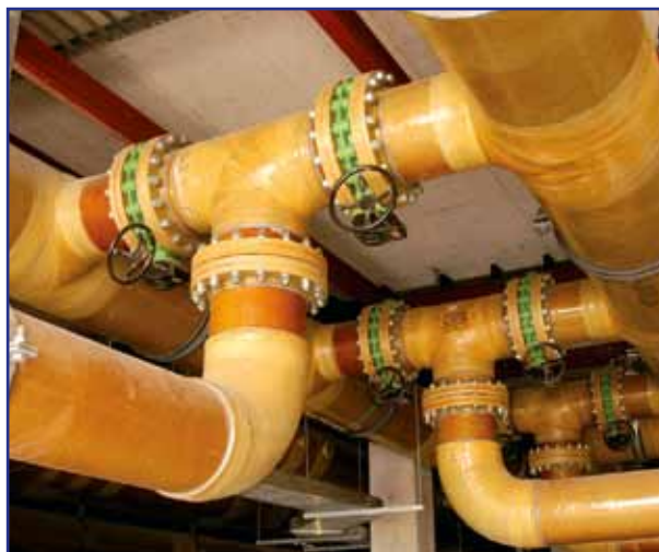
Рис. 7.7. Трубопровод с потолочными опорами
