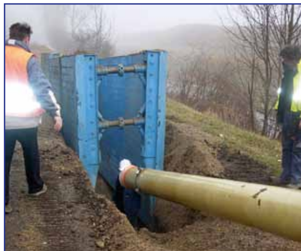
Рис. 6.1. Траншея в нестабильном грунте
